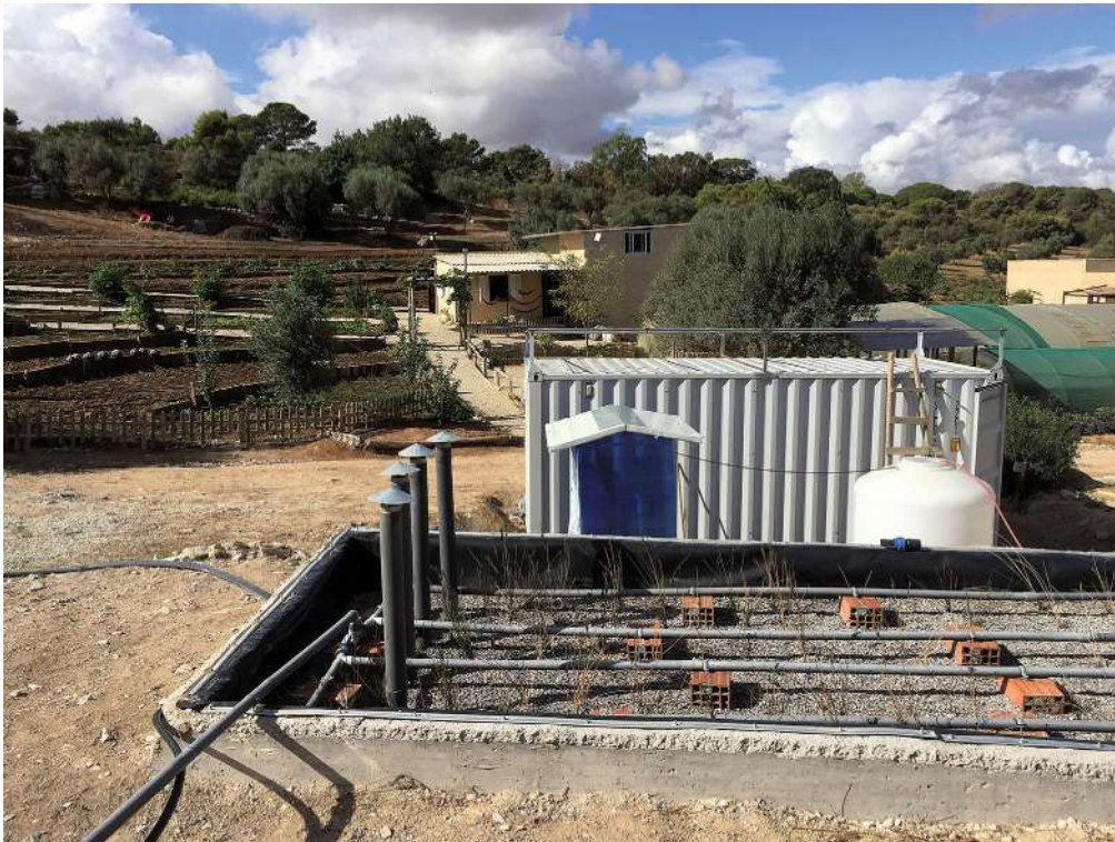
Bild 1: Blick auf das gerade fertig gestellte NBS-System (Vordergrund) und des Containers der Entsalzungsanlage, eingebettet in das Gelände der GDA Sidi Amor, Tunesien
